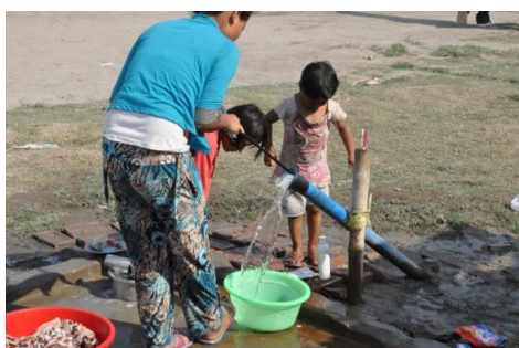
・避難所での給水設備：給水タンクから続くポリエチレン管に手押しポンプを取り付け
