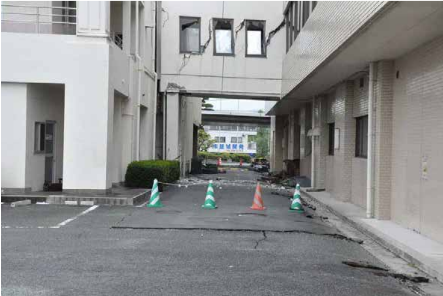
盛土部の沈下での渡り廊下に段差亀裂が(益城町宮園)
