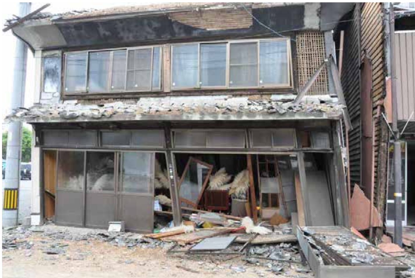
道路沿いの開口部の広い瓦屋根の店舗兼住宅(益城町木山)
