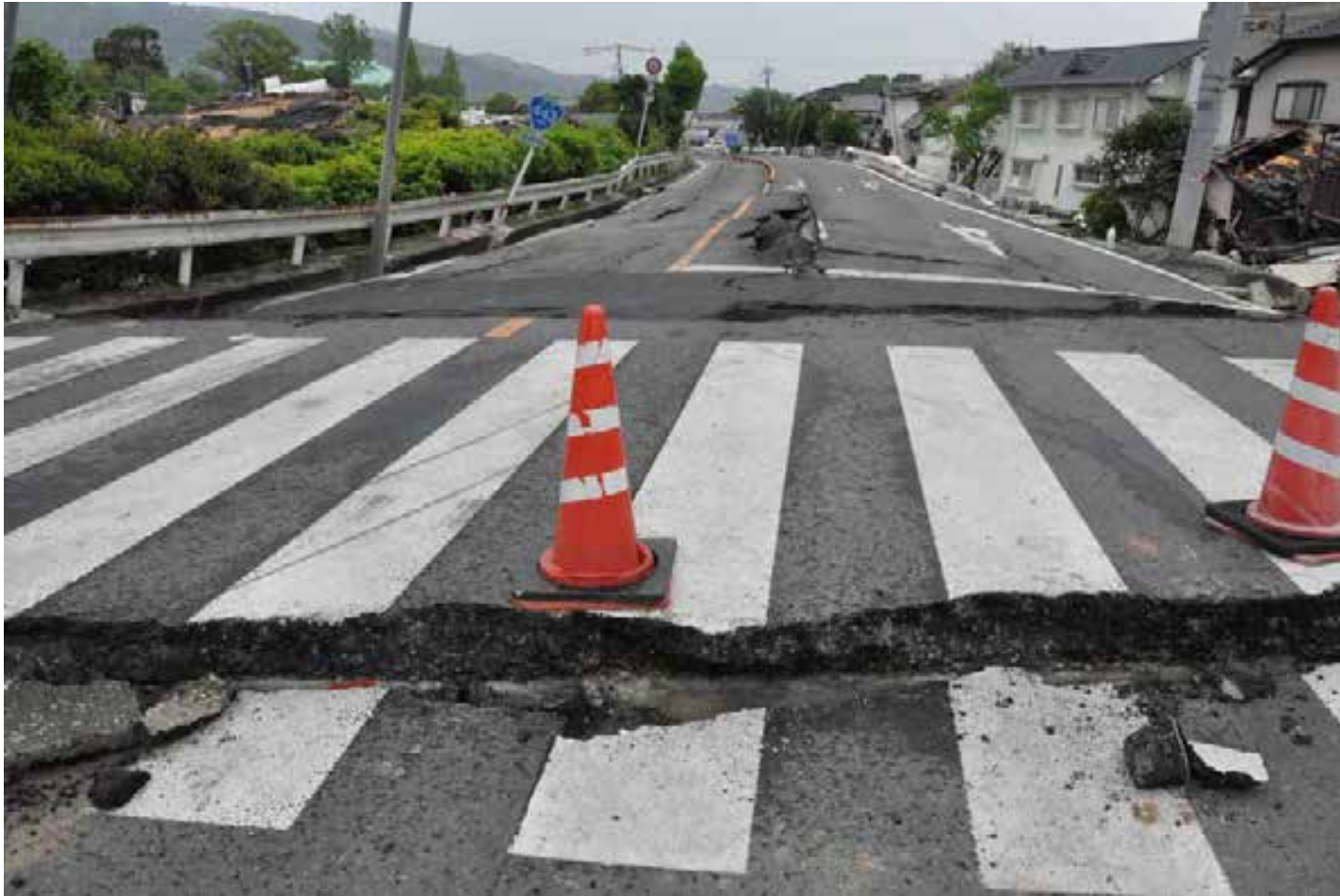
橋梁手前の盛土部沈下(益城町寺追)
